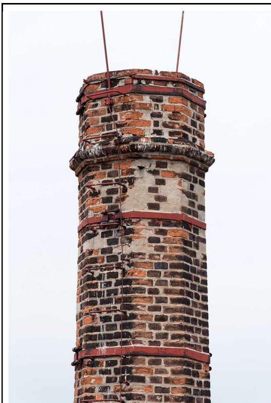
Obr. 57: Dřík s ubouranou hlavicí někdejšího skladu čp. 945 (pasport č. 12). Ve zdivu dříku jsou patrné i maltové vysprávky.
