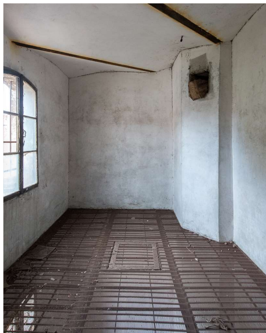
Obr. 42: Horní prostor sirné komory s odtahem zplodin do komína ve skladu čp. 380 (pasport č. 03).
