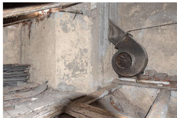
Obr. 49: Dodatečně napojený radiální ventilátor na komín. V popředí pod ním je odtahový otvor v klenbě sirné komory ve skladu s dnešním čp. 1834 (pasport č. 15).
